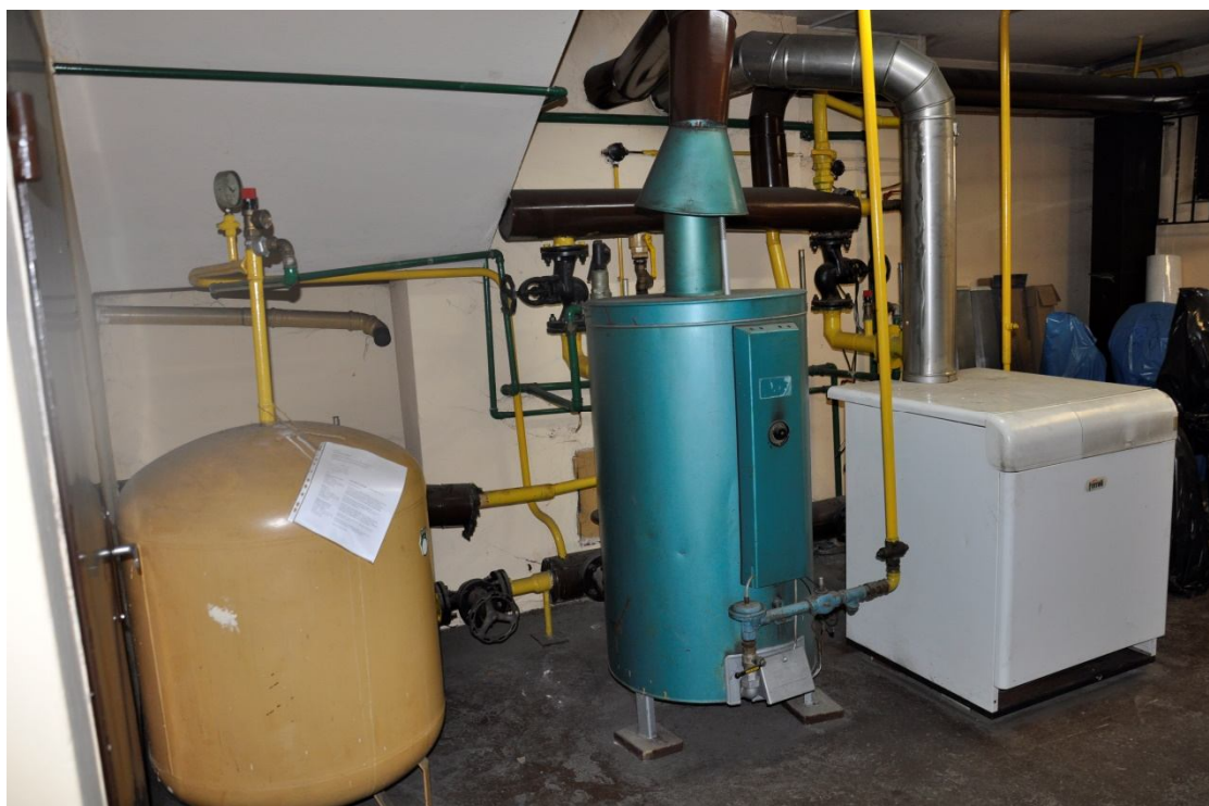
Fot. 3. Kotłownia w budynku Urzędu Gminy Kęty. Stan przed realizacją projektu.
